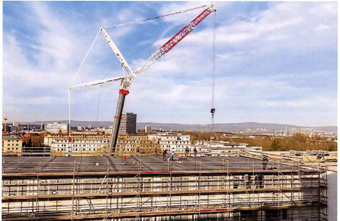
28 Tonnen wiegt das Teil, mit dem die Aufstockung am kkm nun komplett ist. Jetzt folgen Fassaden- und Innenarbeiten. Foto: hzb/Sämmer
